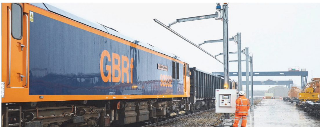
Рис.2 Инновационная технология обеспечивающая смещение контактной сети для проведения погрузочно-разгрузочных работ
