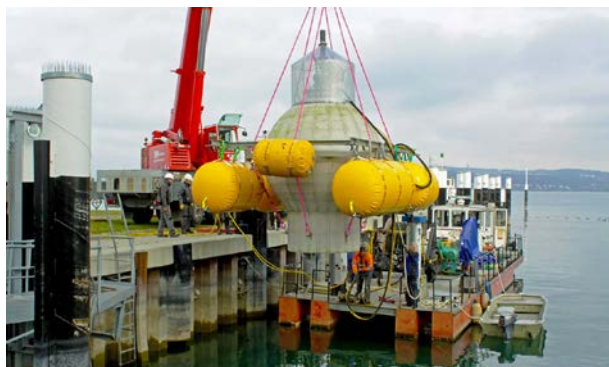
Рис. 27. Прототип нового накопителя энергии подводного типа
