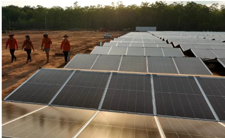
Рис. 14. Солнечная электростанция под названием Maverick
