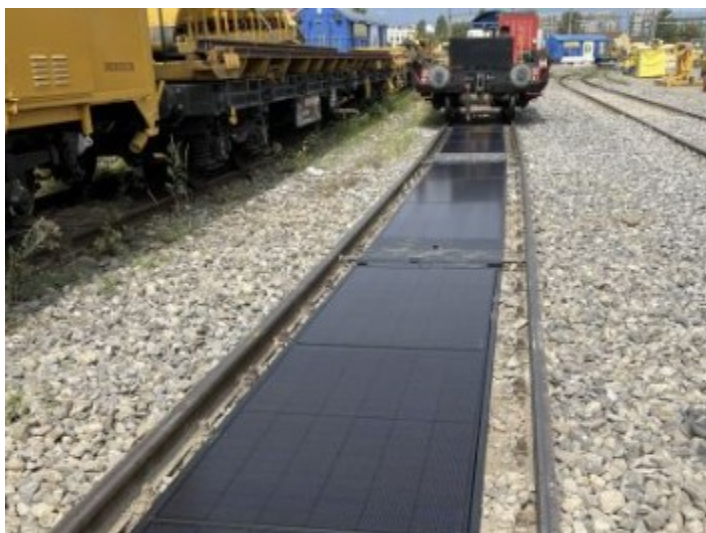
Рис. 8. Солнечные панели на железнодорожных путях
