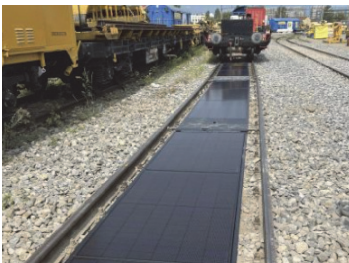
Рис. 15. Солнечные панели на железнодорожных путях
