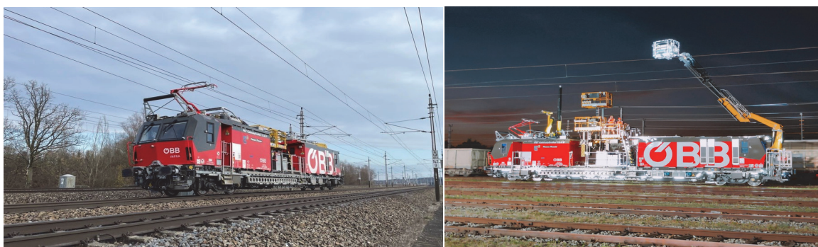
Рис. 4. Путьевая машина Plasser CatenaryCrafter 15.4 E 3 на испытаниях в Австрии
