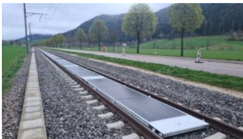
Рис. 6. Солнечные панели на железнодорожных путях
