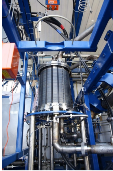
Рис. 2. Новая электролизная батарея на анионообменной матрице без защитного кожуха
