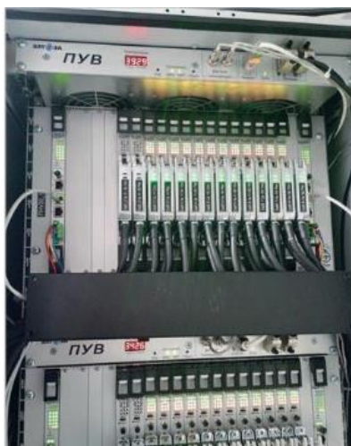
Шкаф объектных контроллеров ОК-ЭЛ-20
