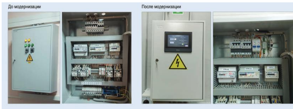
Запроектированные щиты энергоснабжения ЩАП до и после модернизации
