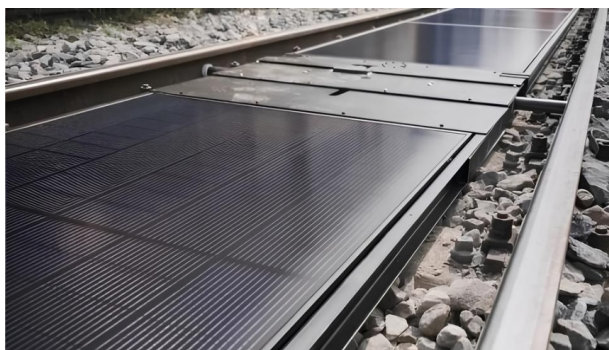
Рис. 1. Съёмная солнечная электростанция (СЭС), размещённая непосредственно на действующем железнодорожном пути
